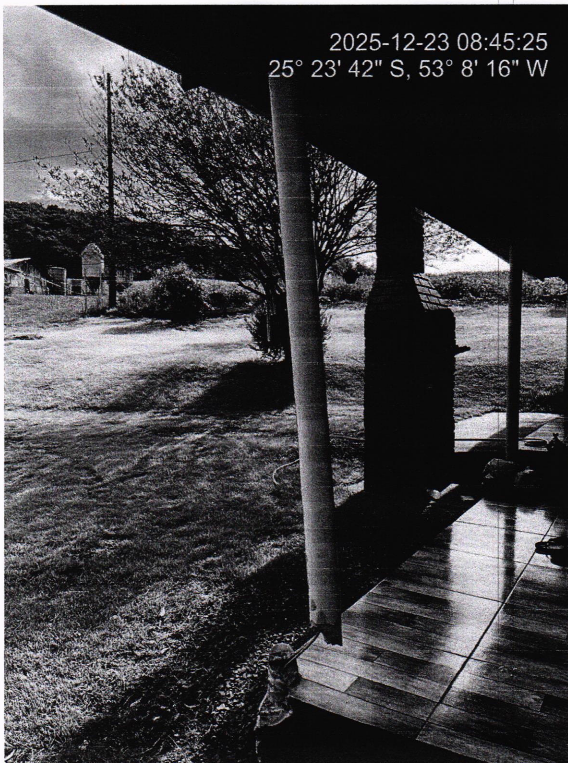
Imagem 08 – Ruptura de Pilar da estrutura.
